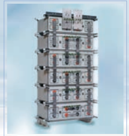
Рис. 8 Смонтированная батарея Absolyte
