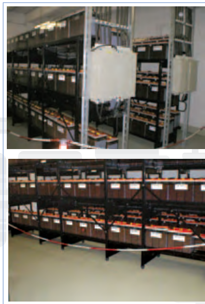
Рис. 23 Смонтированные батареи Classic Energy Bloc
