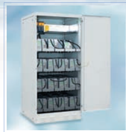
Рис. 7 Смонтированная батарея Marathon L
