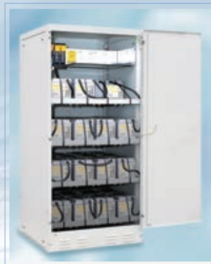
Рис. 13 Смонтированная батарея Powerfit S
