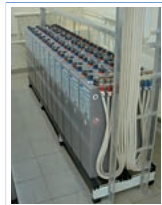
Рис. 18 Смонтированная батарея A600 OPzV
